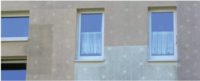
Dübelkopfabzeichnungen durch Verarbeitungsfehler oder falsche Dübelauswahl können nachträglich nicht mehr dauerhaft beseitigt werden.
