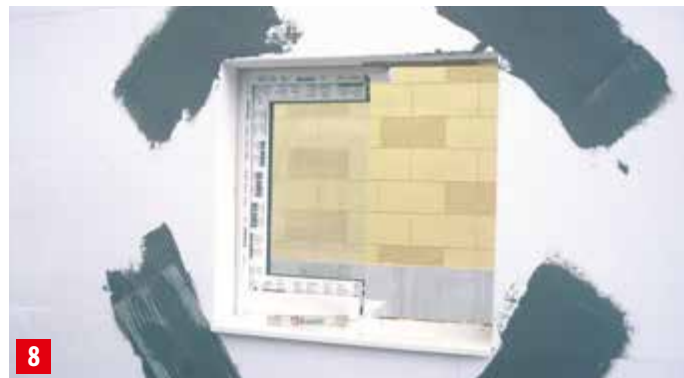
8 Prídavná výstuž v rohoch otvorov sa ukladá do vopred nanesej vrstvy lepidla, povrch sa následne zahladí. Po celoplošnom stierkovaní má byť krycia vrstva lepidla v tomto mieste min. 0,5 mm.
