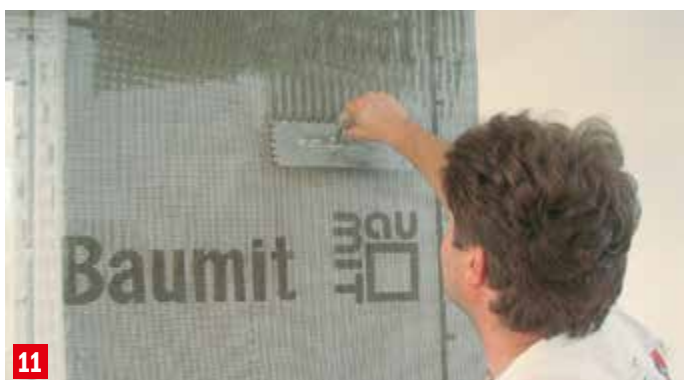
11 Pomocou antikorového hladidla sa mriežka vtlačí do lepiacej stierky a povrch sa dôkladne zahladí.
